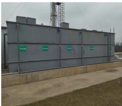
厂区污水处理站
