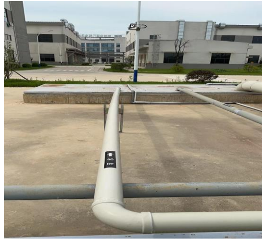
污水输送管线（明管架空、走向标识）
