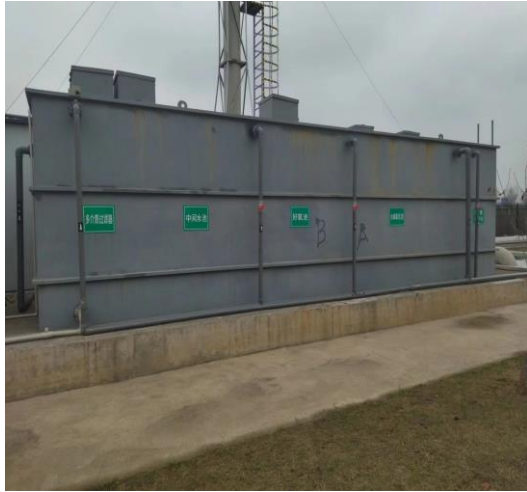
厂区污水处理站
