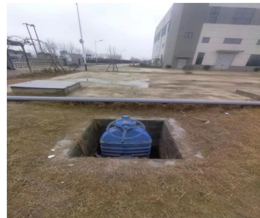
厂区雨水总排口截断阀
